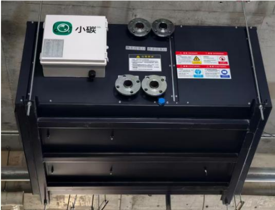
小碳水区除湿机现场实拍图
